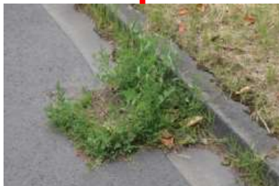
Letzter Gully, teilweise geteert, zugewachsen
