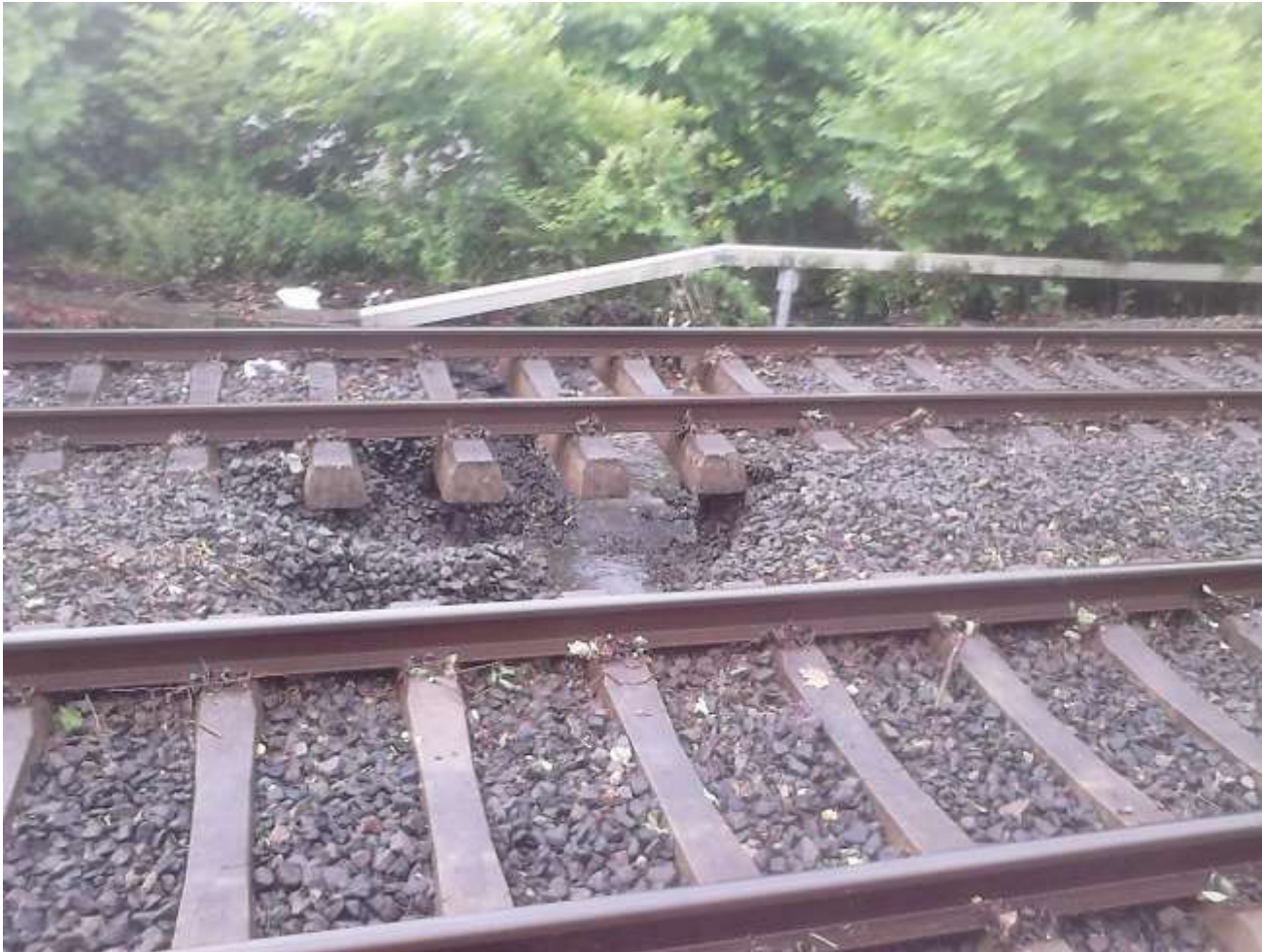
Abb. 10: Bahnhof Merklinde - unterspülte Gleisanlage, 15:06
