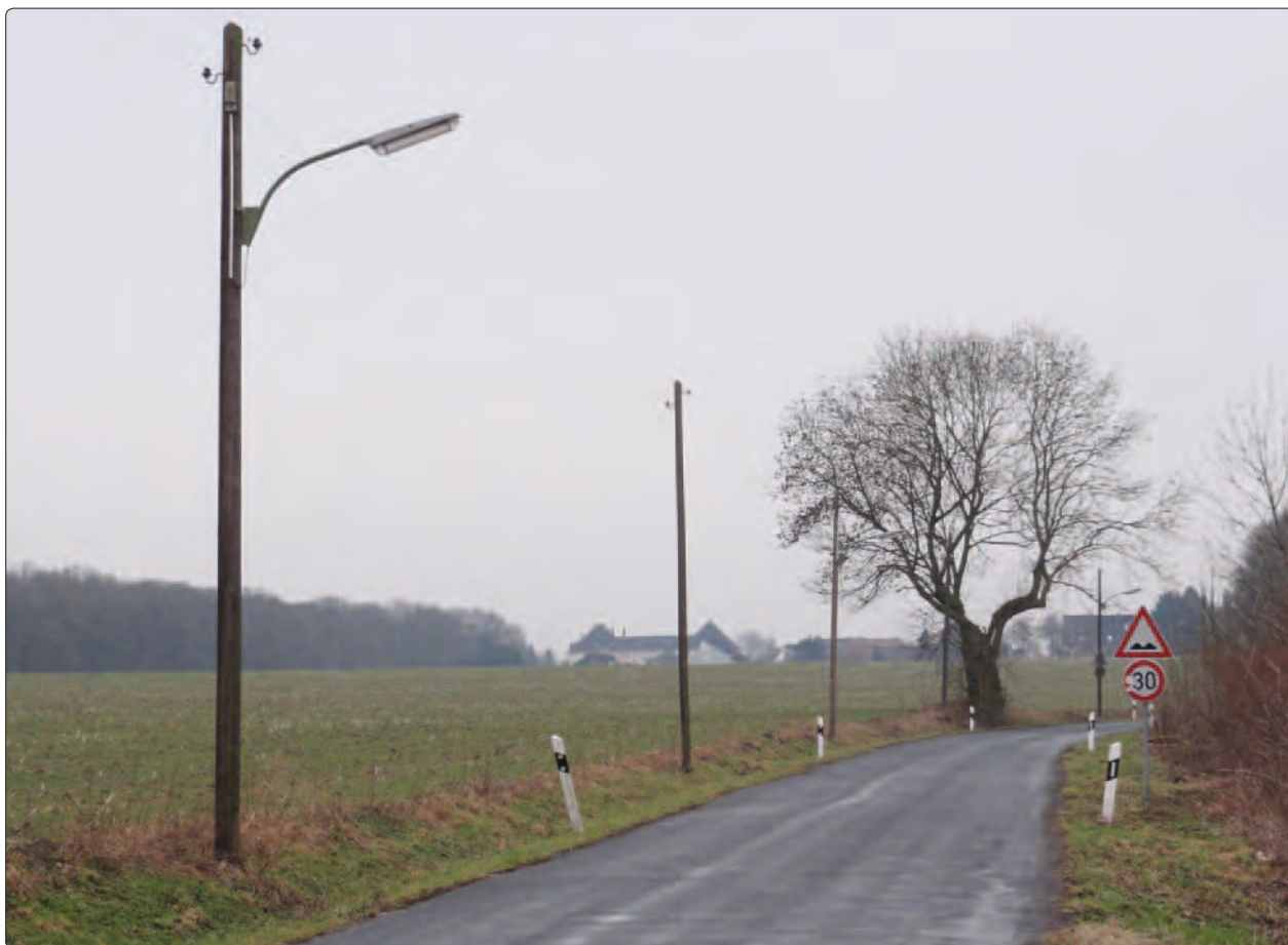
7.1 // Auslegerleuchte am Holzmast
