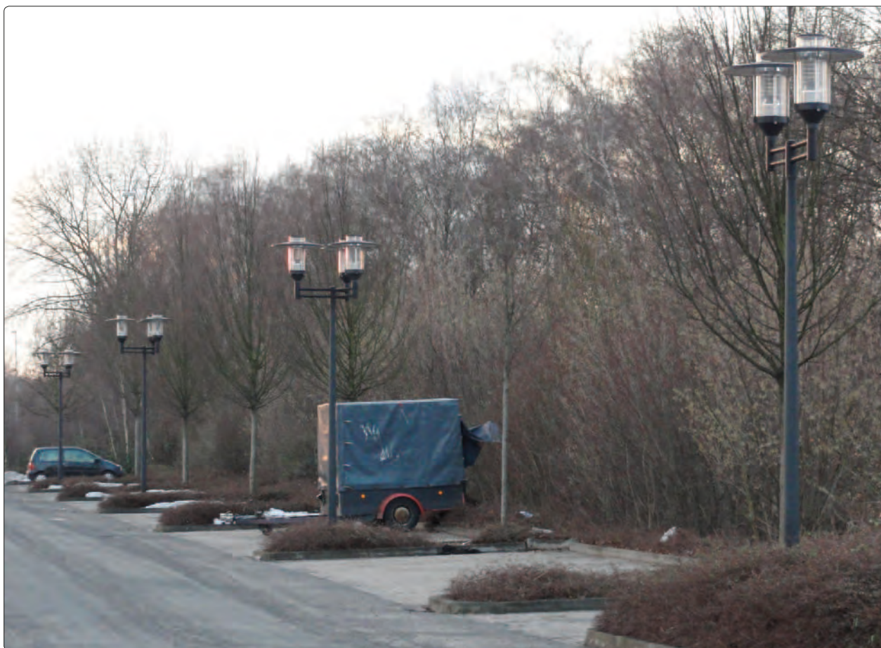
7.2 // Übermenge dekorativer Leuchten als Parkplatzbeleuchtung
